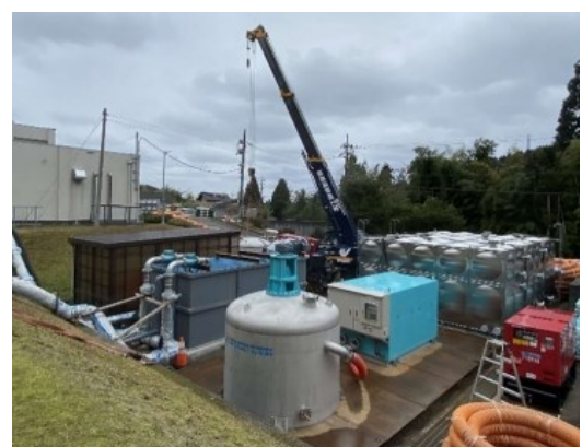
可搬式浄水施設・設備（珠州市）
