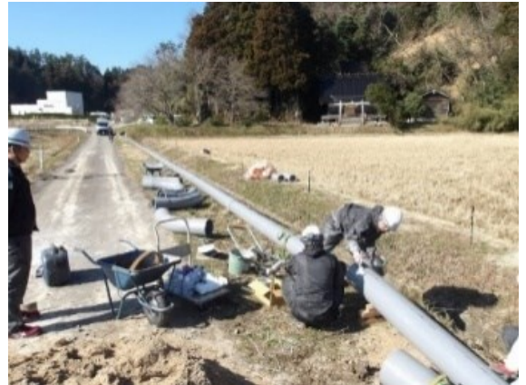
下水を集約し処理場に送る圧送管の被災（珠州市）
