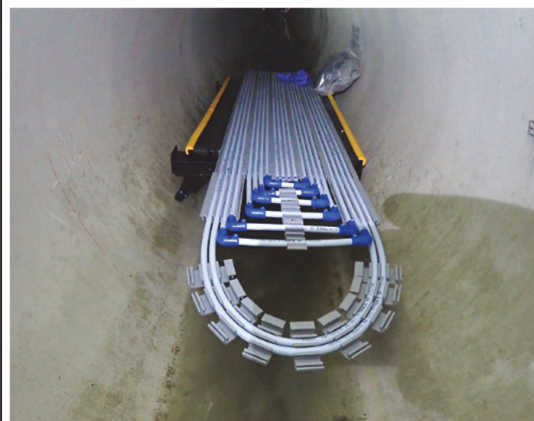
下水道管内に設置した熱交換器
