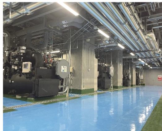
熱供給プラント
