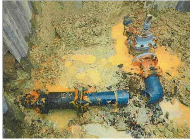
塩ビ管ベンド割れ(石川県珠洲市)
