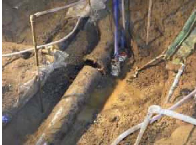
DIP(A)継手部抜け(新潟県柏崎市)
