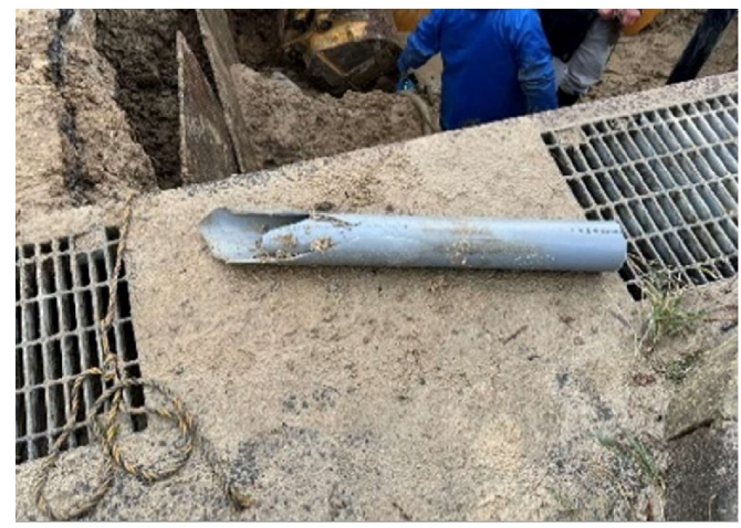
塩ビ管の割れ(石川県中能登町)
