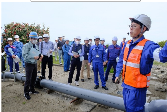
広範囲で下水管内滞水の要因となった処理場直結の圧送管被災現場
