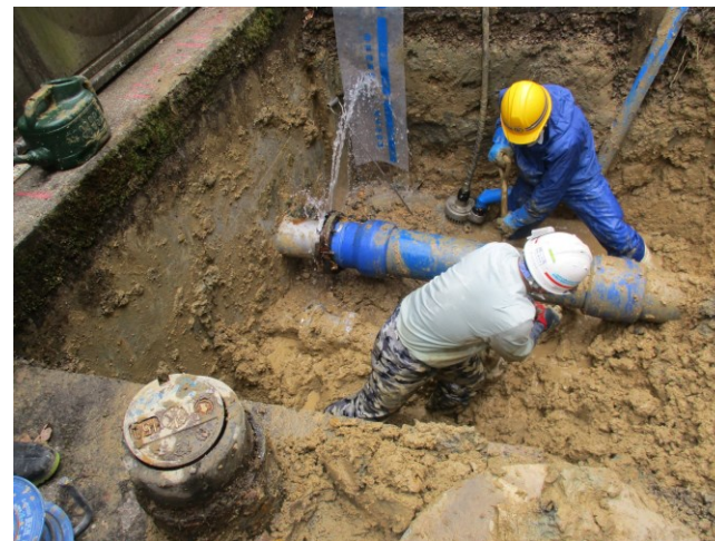
若山配水池流出管の漏水
