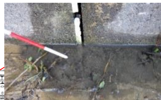
1系OD槽目地の隙間・ズレによる汚水の漏れ
