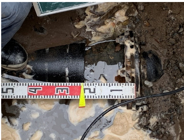
既設圧送管 破損状況写真
