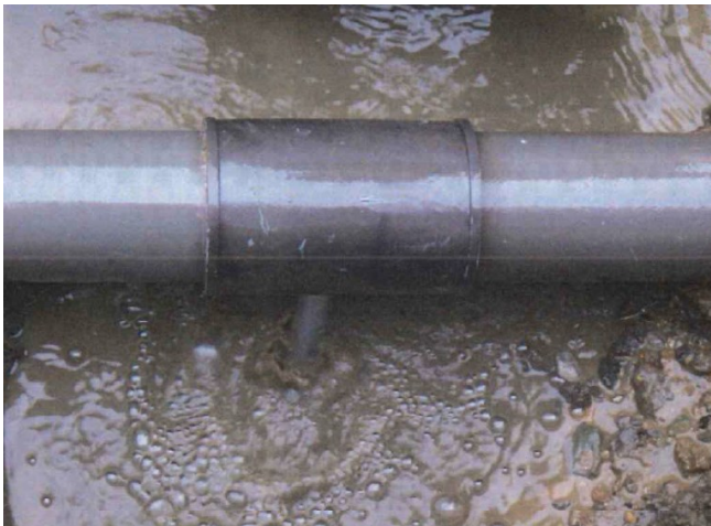
塩ビ管直管割れ(新潟県新潟市)
