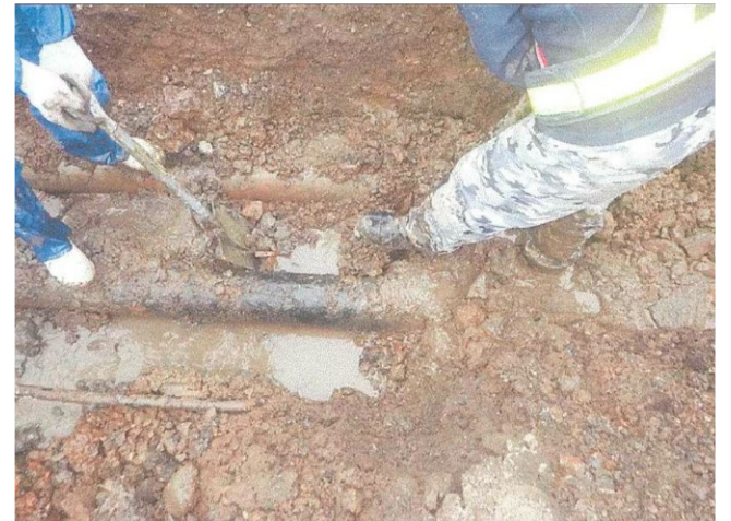
DIP(A)管体割れ(石川県珠洲市)
