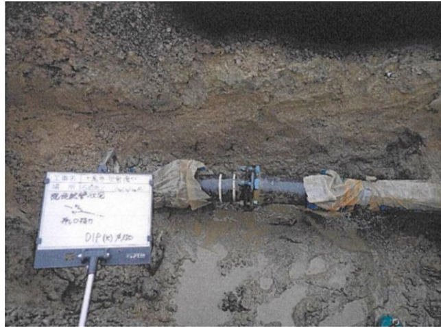
DIP継手部漏水(石川県七尾市)
