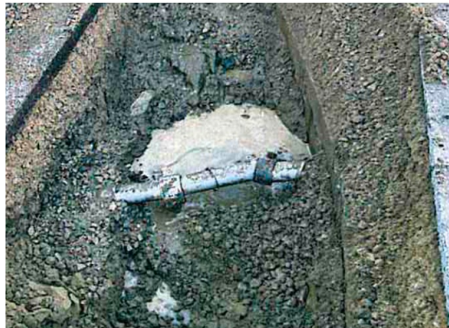
SP管体破損(石川県羽咋市)
