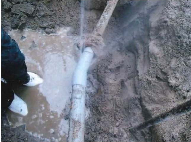
塩ビ管ベンド割れ(新潟県新潟市)
