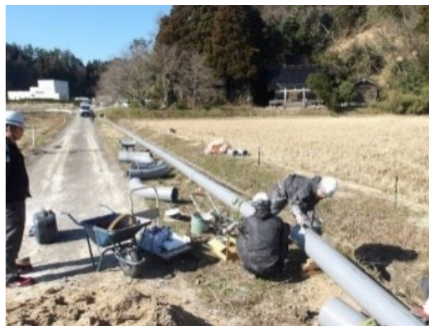
区域の下水を集約し処理場に送る圧送管の被災（珠洲市熊谷ポンプ場からの圧送管）
