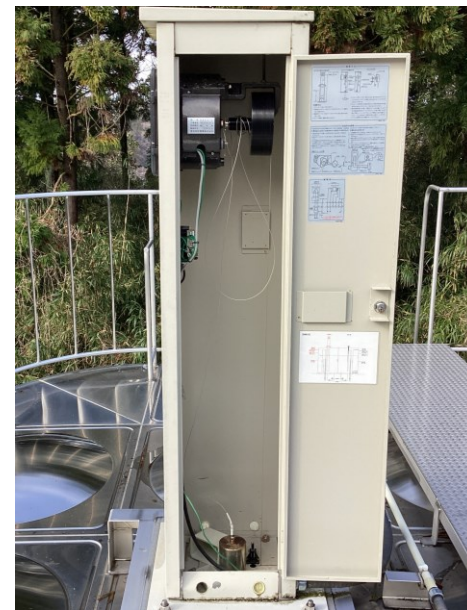
狼煙配水池フロート式水位計の損傷
