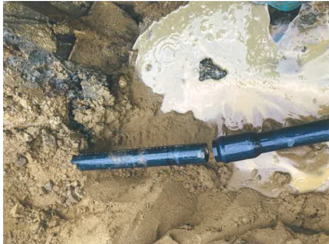
HIVP継手部抜け(石川県津幡町)
