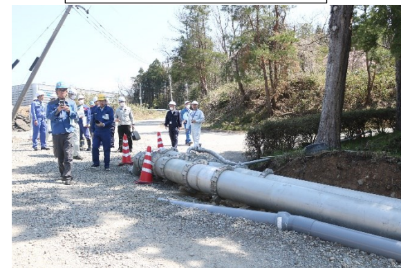
広範囲の断水が生じた配水池への送水管の破損現場
