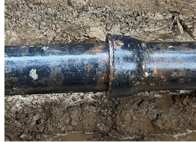
DIP(T)継手部抜け(石川県穴水町)
