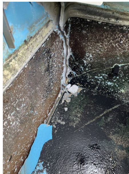
宝立浄水場沈澱池の躯体ひび割れ
