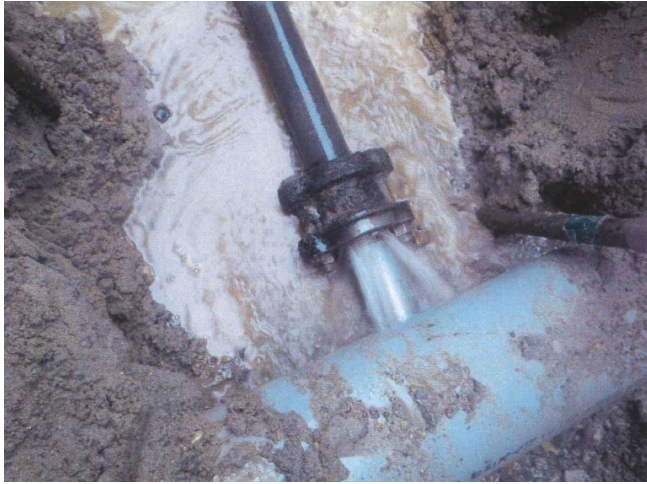
SP継手部の抜け(新潟県新潟市)
