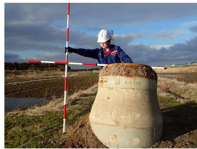
マンホール浮上現場(中能登町)
