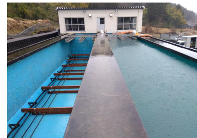
浄水場の被災(珠洲市宝立浄水場の沈殿池)
