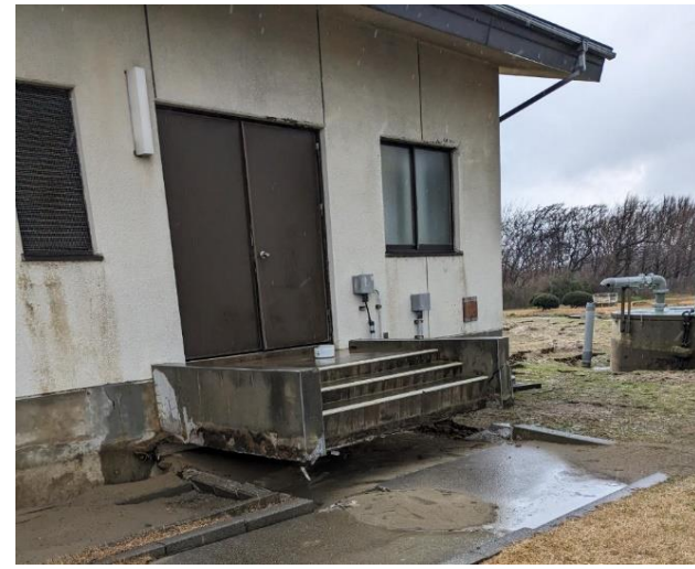
処理場施設の被災(羽咋市)
