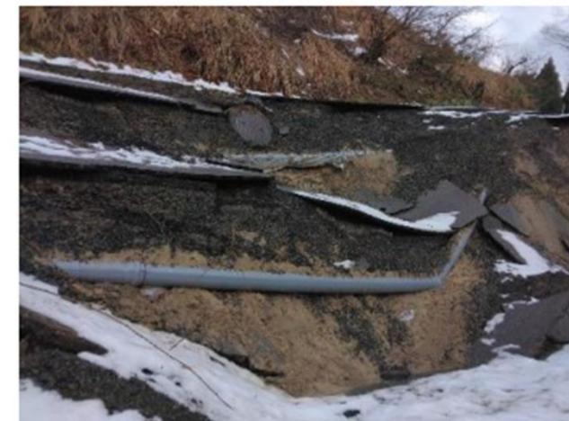
配水池に水を送る送水管の被災(輪島市送水管)
