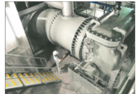
雨水ポンプ施設
