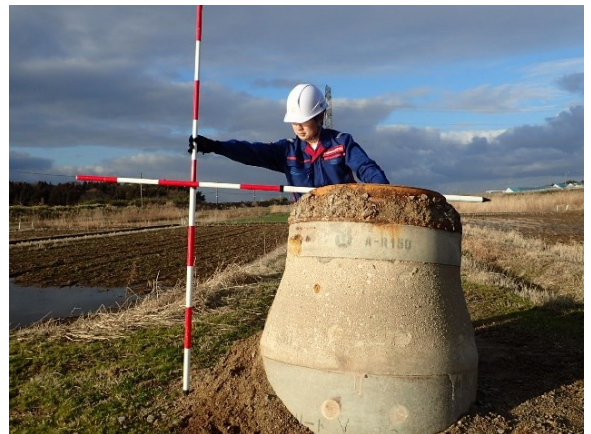
マンホール浮上（中能登町）
