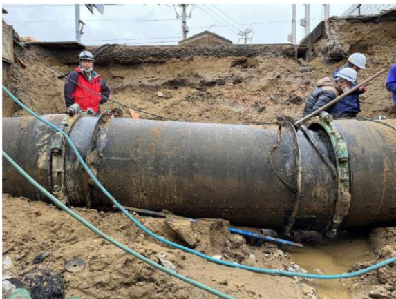
送水管の被害（七尾市）
