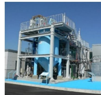
リン回収施設
