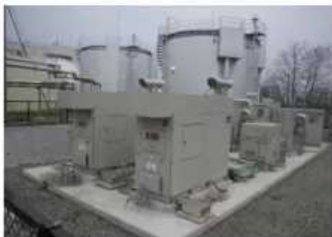
宮渚浄化センター消化ガス発電設備
