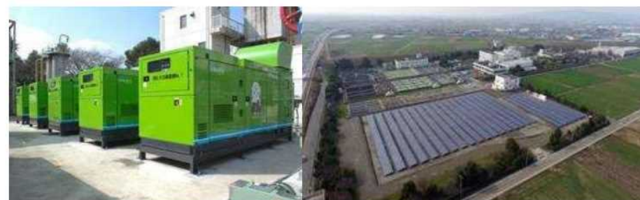
図 2-3 消化ガス発電設備(左)、太陽光発電設備(右)
