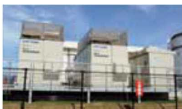
写真 消化ガス発電設備（燃料電池）
