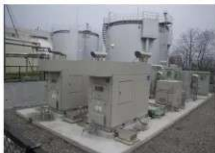
宮沢浄化センター消化ガス発電設備
