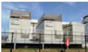
写真 消化ガス発電設備（燃料電池）
