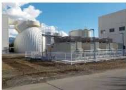
岡島浄化センター消化ガス発電設備
