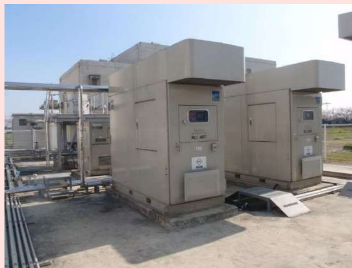
南部浄化センター 消化ガス発電設備
