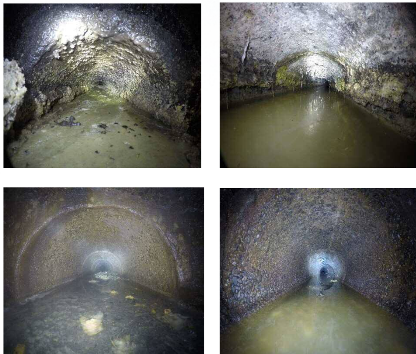
写真 管路腐食状況
