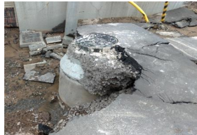
液状化による管路の被害(イメージ)
