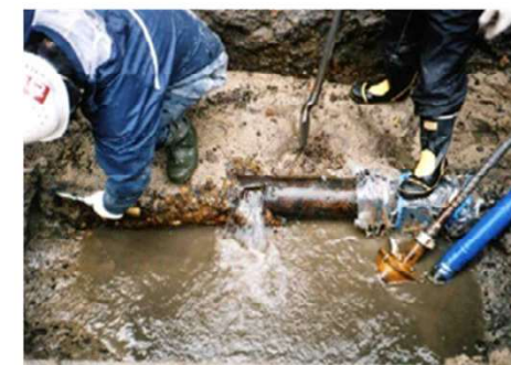
埋設後60年経過した鋳鉄管の漏水
