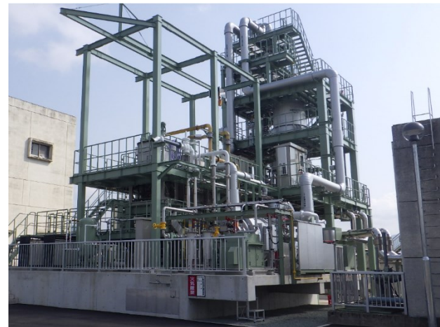
脱水乾燥設備（令和7年3月完成）
