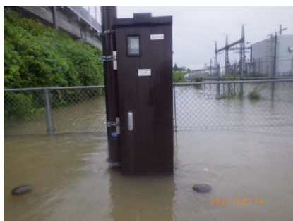
浸水したマンホールポンプ制御盤
