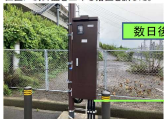
制御盤を上げる前
