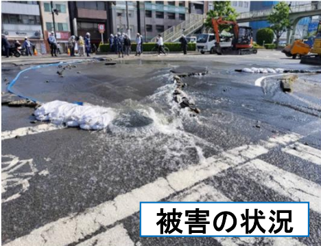
事故の発生状況
