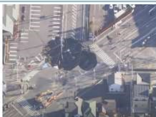
1月31日時点の事故現場の状況
