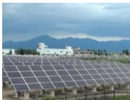
山形県 山形浄化センター
