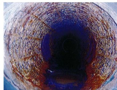
劣化度Aの状況
