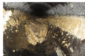
脂で閉塞した管路（出典：川崎市HP）
