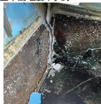
浄水場沈澱池の躯体ひび割れ
