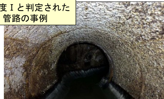
管の腐食から緊急度Ⅰと判定
