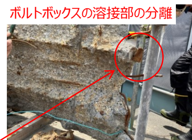
（事故後撮影） ボルトボックスの溶接部の分離 隣接リングのボルトボックスと結合した状態
