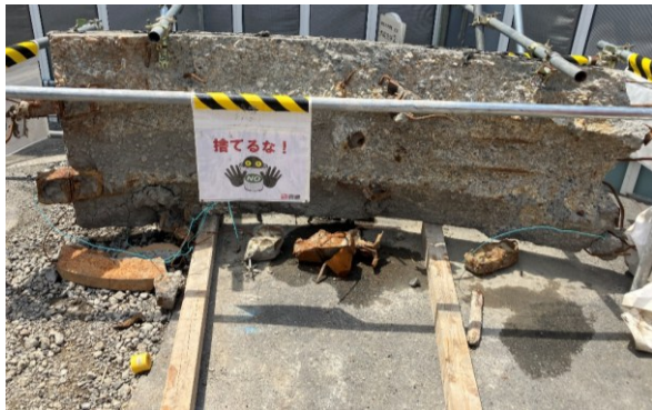
写真① 回収RCセグメント1 (事故後撮影)
