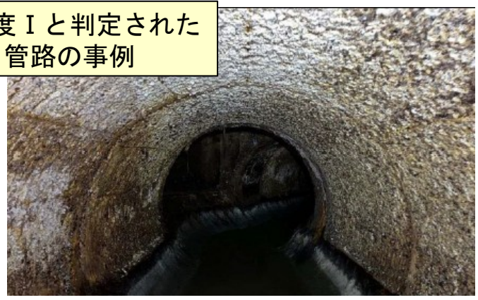
管の腐食から緊急度Ⅰと判定
