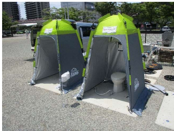
第一カッターきいろ公園(中央公園)に設置された 災害用井戸を水源として活用したマンホールトイレ
