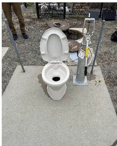
井戸水を活用した水洗システム
