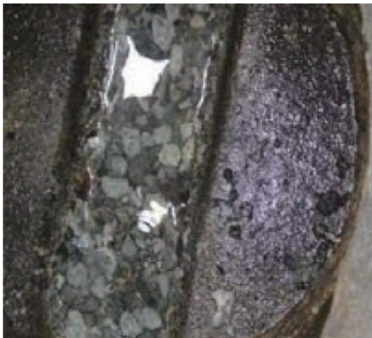
インバート部の損傷
