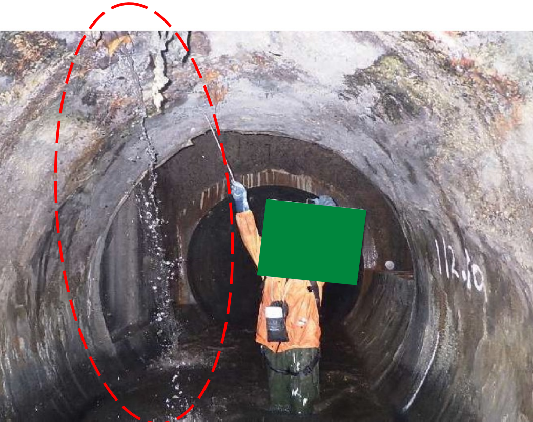
排除区分: 污水管 布設年度: 1979年 自治体判定: 浸入水a、ゴムシート露出 対策の見通し: 更生工事、R7年度実施予定
