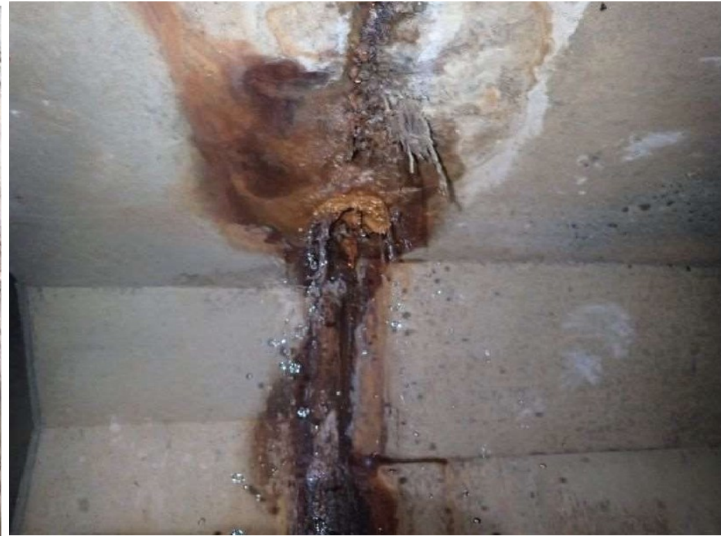
排除区分: 雨水管 布設年度: 1981年 自治体判定: 浸入水a、破損・クラックb 対策の見通し: 補修工事、R7年度実施予定
