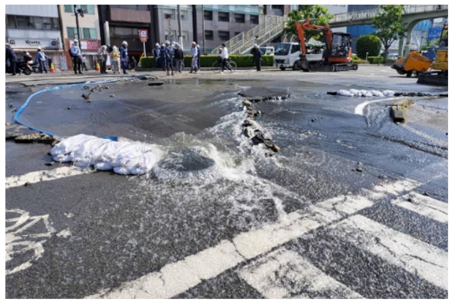
京都市国道1号で発生した漏水事故 (4/30)
