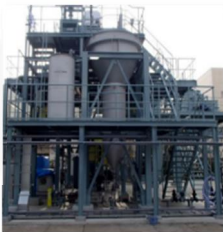
横浜市リン回収施設
