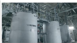
東京都リン回収施設
