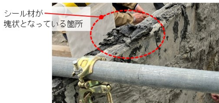
写真3.2 シール材の状態
