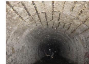
直ちに改築が必要と判定された事例
