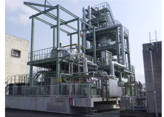
脱水乾燥設備（令和7年3月完成）
