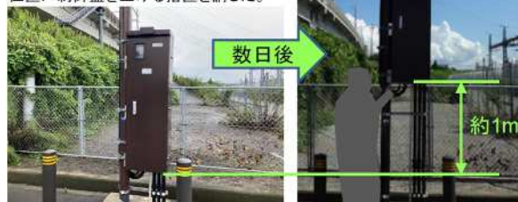
制御盤を上げる前
