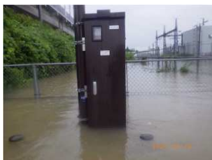
浸水したマンホールポンプ制御盤
