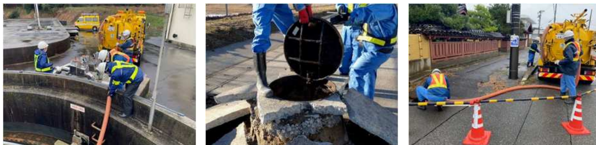
図 3-4 最終沈殿池からの採水および下水道管路の流下機能の確認の様子
