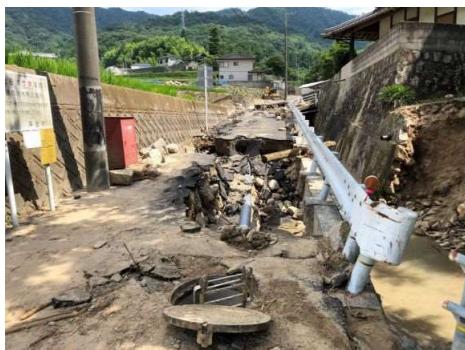
被災状況 (海田町)
