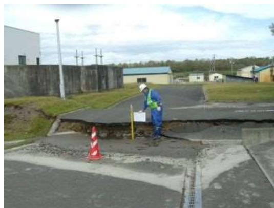
鶴川終末処理場内の地盤沈下
