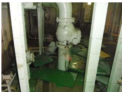
高梁浄化センター内の浸水状況
