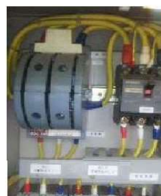
商用から発電機に切り替える
