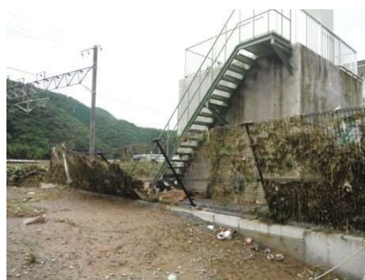
広瀬雨水ポンプ場の被災状況（高梁市）
