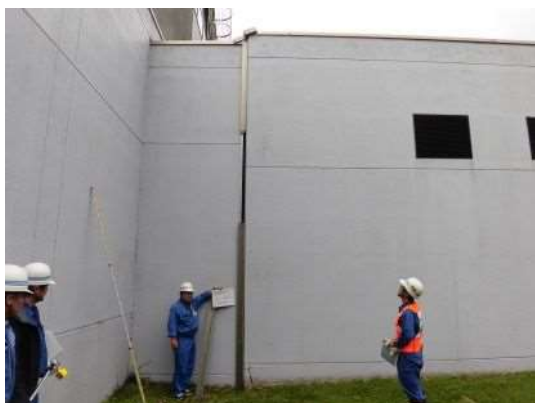
早来浄化センターの構造物継目部のズレ
