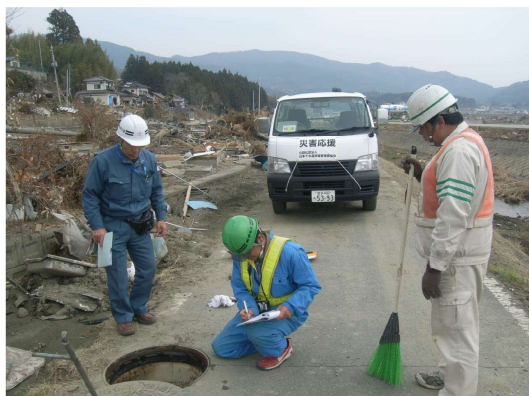
被災調査状況 (岩手県大船渡市)
