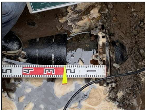
管の破損（抜出し）
