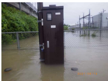
浸水したマンホールポンプ制御盤
