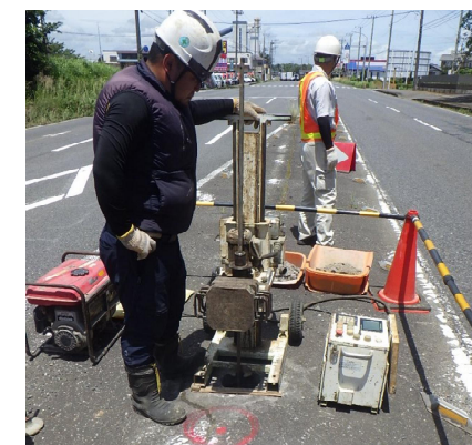
貫入試験による空洞調査
