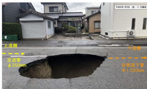
< 事故直後の現場状況 >
