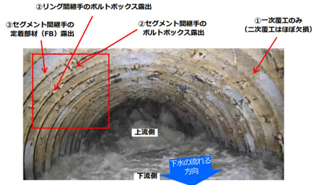
飛行式ドローン調査の写真(2月5日) (八潮市で発生した道路陥没事故に関する原因究明委員会 中間とりまとめ【令和7年9月4日】より)
