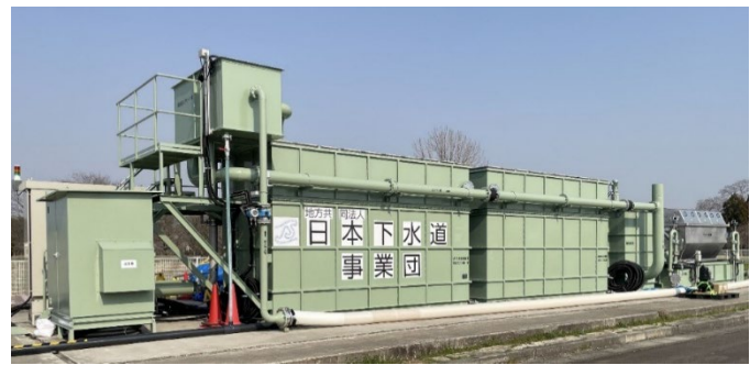
可搬式水処理施設 簡易処理で1日約6,000人分処理可能
