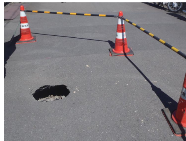
下水道管に起因した道路陥没の一例
