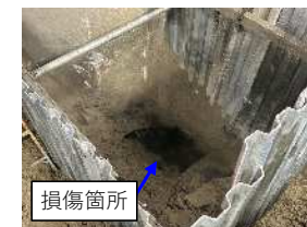
下水管路の損傷状況
