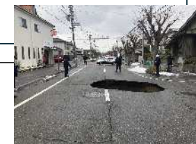
道路陥没発生
