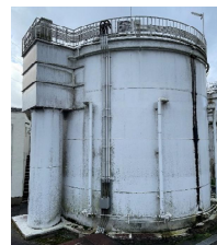
PFAS対策の例 (活性炭処理施設)
