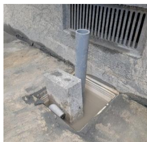
濁り水が発生した個人 宅の井戸
