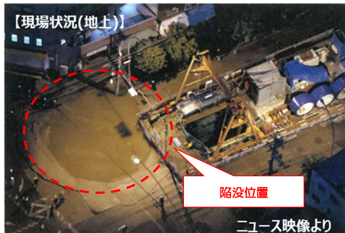
(写真1) 事故発生時道路陥没状況写真
