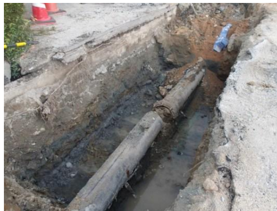
水道管の被害
