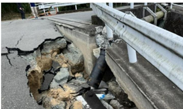
破断した管路（氷川町）
