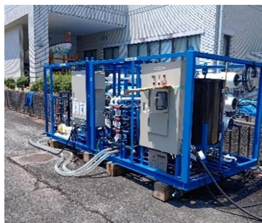
水資源機構の浄水装置による飲料水・生活用水の製造
