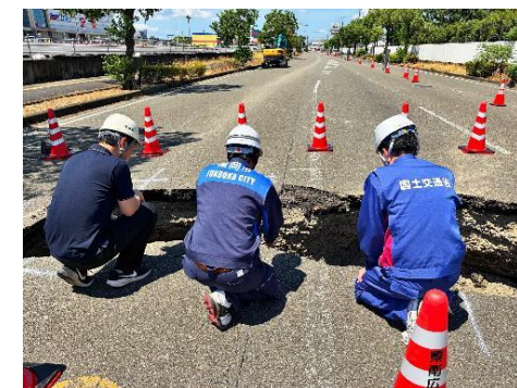
国土交通省等による陥没現地確認(八代市)
