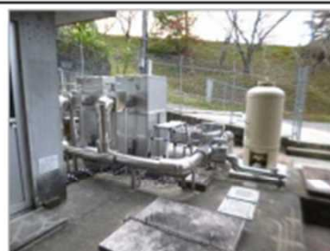
概観 左：加圧ポンプ2基 右：圧力タンク
