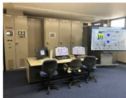
中央監視制御設備のHMI等
