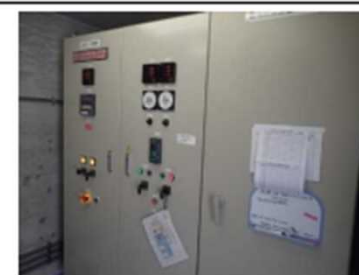
ポンプ制御盤 インバータ機器(5.5kW)
