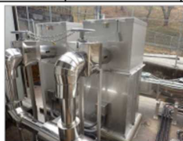
加圧ポンプ 1号(5.5kW), 2号(5.5kW)
