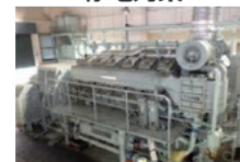
例：自家発電機の整備
