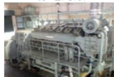
例：自家発電機の整備
