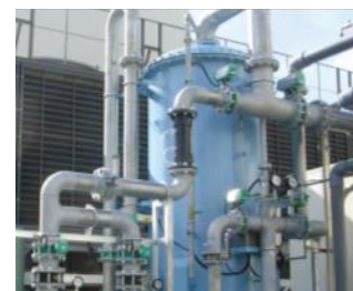
急速ろ過器 除鉄除マンガンろ過器
