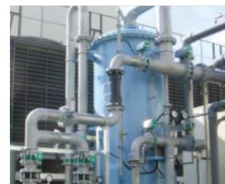
急速ろ過器 除鉄除マンガンろ過器
