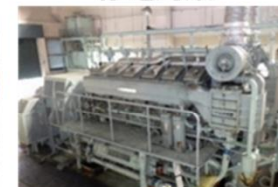
例：自家発電機の整備
