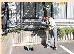
宅内漏水調査
